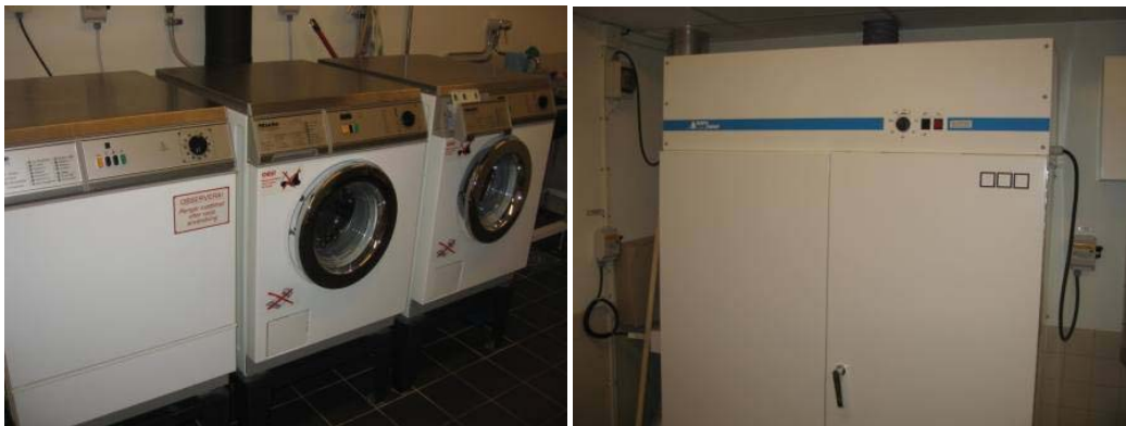
Tvättstugan i fastigheten.
