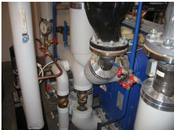
Fjärrvärmväxlaren i fastigheten
